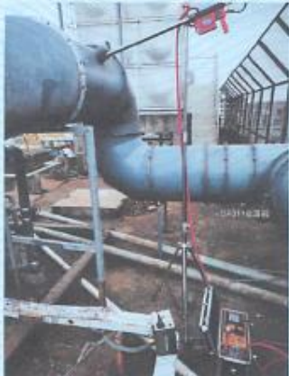
G19 喷砂废气 DA011 处理前检测口
