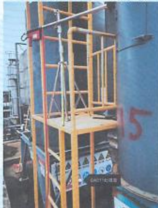
G20 喷砂废气 DA011 处理后检测口
