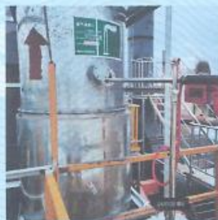
G16 喷砂废气 DA010 处理后检测口
