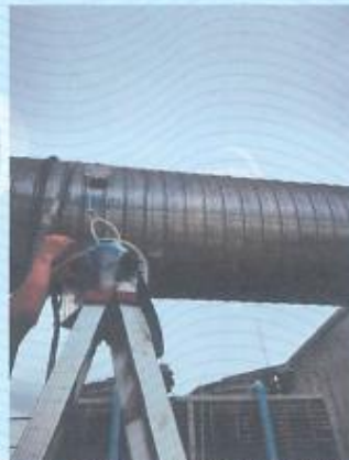
G13 点胶、注塑废气 DA008 处理前检测口 2#
