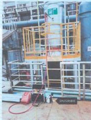
G18 喷砂废气 DA012 处理后检测口
