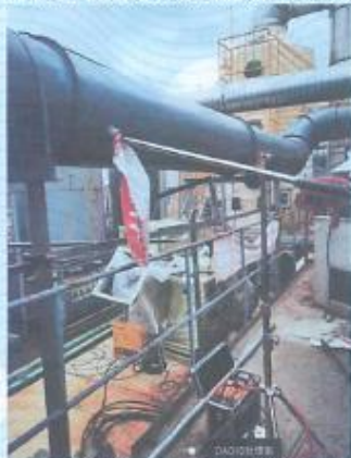
G15 喷砂废气 DA010 处理前检测口
