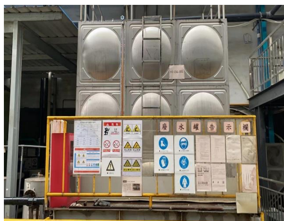
废水收集装置
