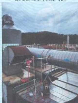
G10 焊接废气 DA004 处理前检测口
